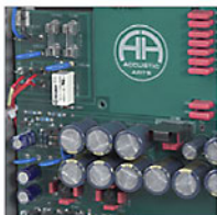
Beide Netzteile des DAC verfügen über eine Kapazität von 84 000 Mikrofarad
